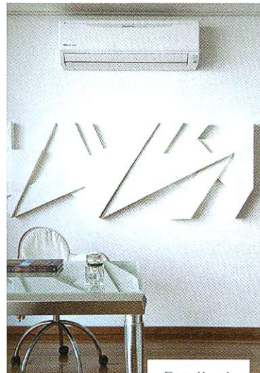
Detalhe do Split Fujitsu Inverter
